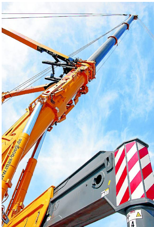
Mit einem Spezialkran werden die Betonringe nacheinander aufgesetzt. Sensoren messen die Windgeschwindigkeit. Bei mehr als sieben Metern pro Sekunde wird der Vorgang gestoppt.
