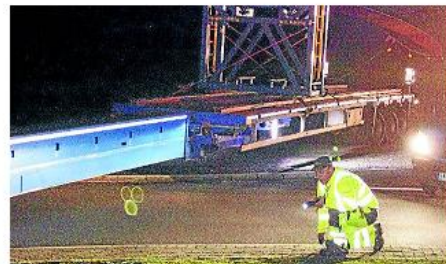
Die Rotorblätter für den Windpark Brechte mussten das verkehrstechnische Nadelöhr Ochtrup durchfahren. Fotos: mfa
